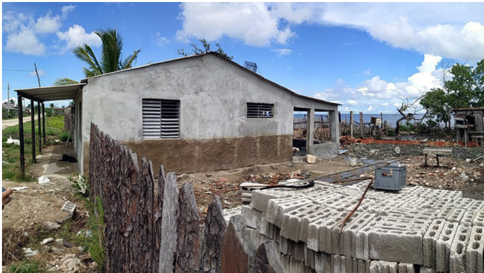
Figura 3. Vivienda siendo reparada con materiales duraderos a escasos metros del mar. Fuente: González G., 2018.
